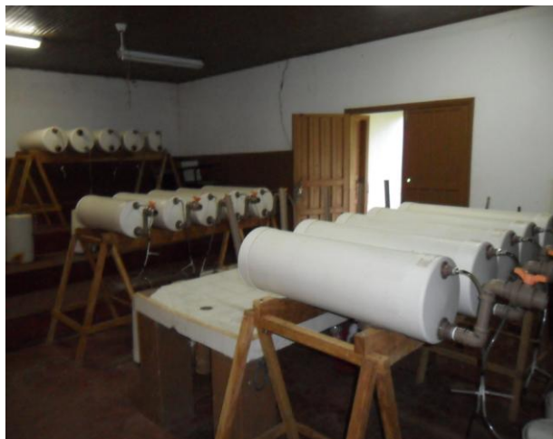
Biodigestores em PVC.
